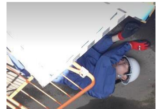
荷の転落による災害
